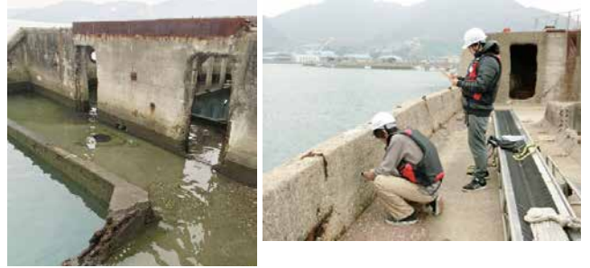
昭和19年に建造され、現存しているコンクリート船の強度調査等を実施。(建築学会大会にて報告)
