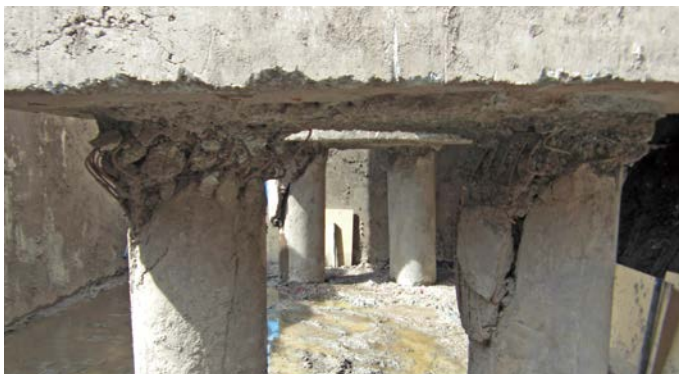
杭の被害例(2016年熊本地震)
